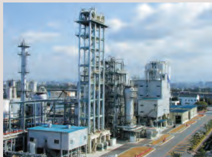
プライムポリマー大阪工場ポリプロピレンプラント
