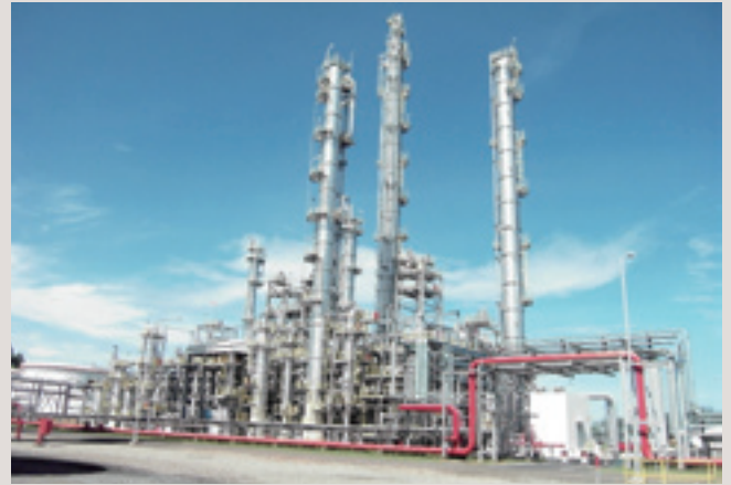
完成したブタジエン製造設備
