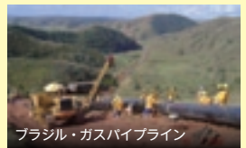
ブラジル・ガスパイプライン
