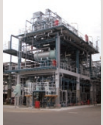
完成したETBEプラント
