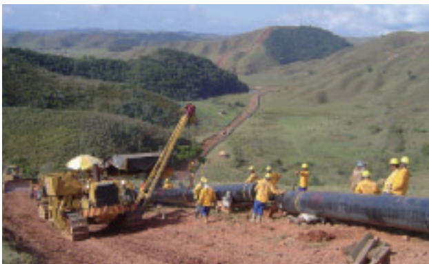
Gas Pipeline of Petróleo Brasileiro S.A. (PETROBRAS)
