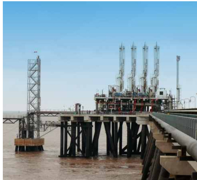
Unloading arms at LNG Terminal, Dahej Client : Petronet LNG Ltd.
