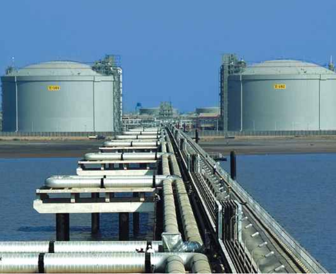
Jetty top piping at LNG Terminal, Dahej Client : Petronet LNG Ltd.
